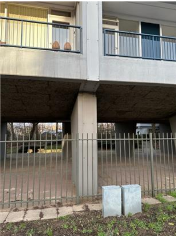
De kabels stijgen via een bestaande koof
